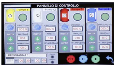
Funzionamento pompe Pumps operation display
