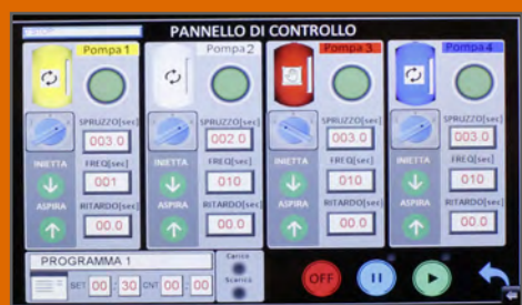
Funzionamento pompe Pumps operation display
